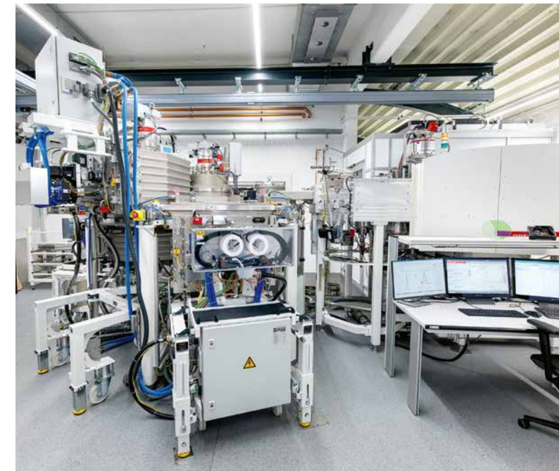
Beschichtungsanlage OPTA X (Von Ardenne) mit unserer EOSS®-Technologie der zweiten Generation für gleichzeitig durchgeführte beidseitige Abscheidung von Interferenzfiltern.
