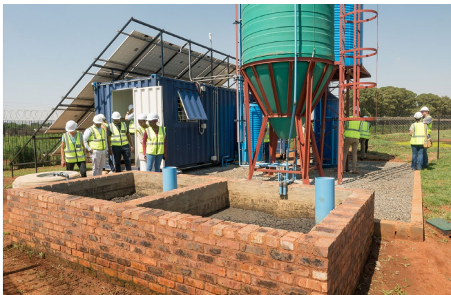
Demonstrationsanlage in Südafrika: Gesamtansicht mit den Solarmodulen zur Versorgung mit dem benötigten Strom. ©Fraunhofer IST, Jan Gäbler
